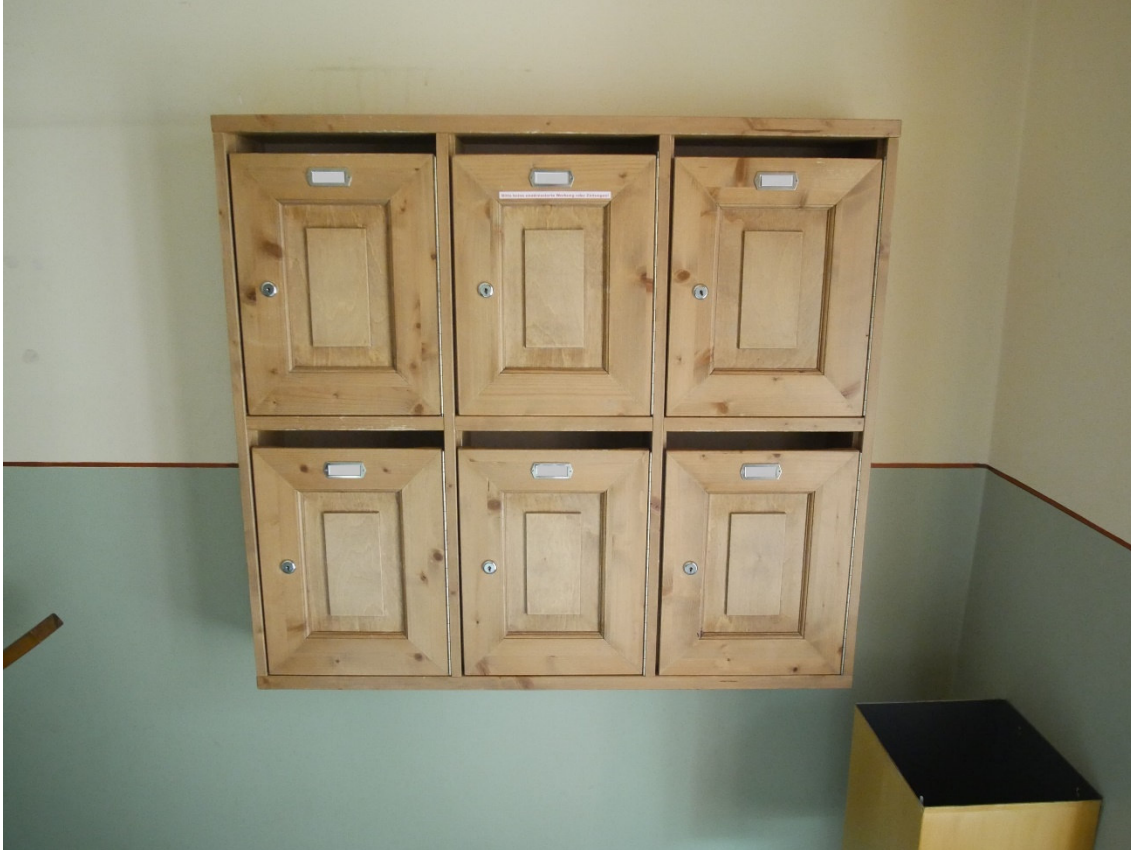
Briefkastenanlage im Haus
