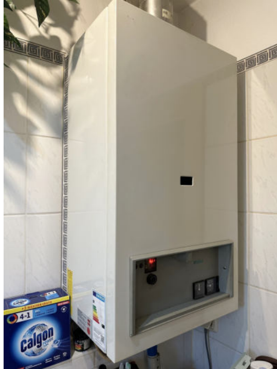
Etagenheizung in alle Wohnungen
