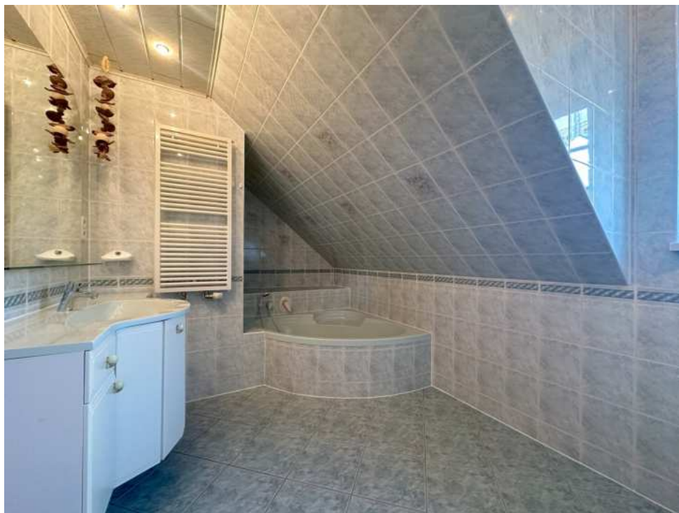
Fußbodenheizung im Bad
